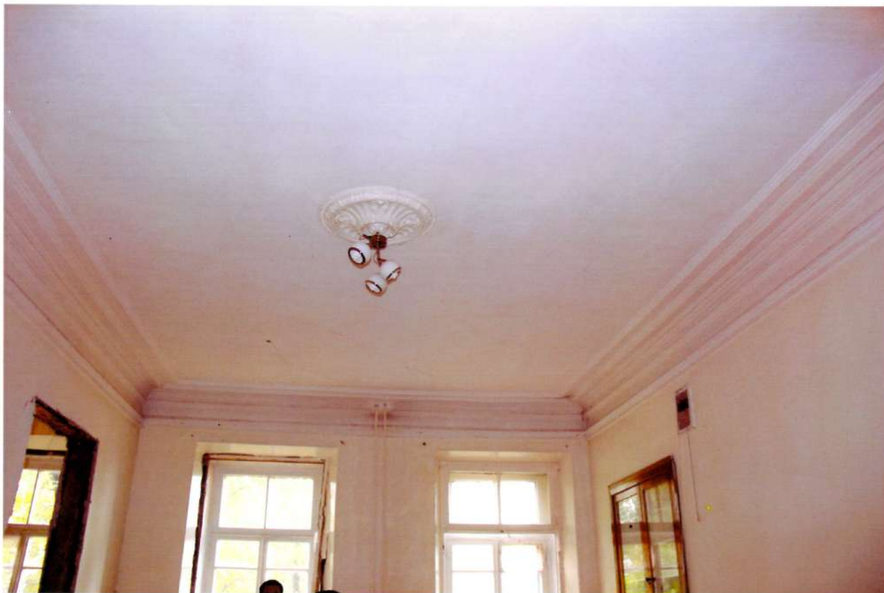
Видовая точка № 41. Потолок квартиры 1-го этажа. Жилой корпус.
