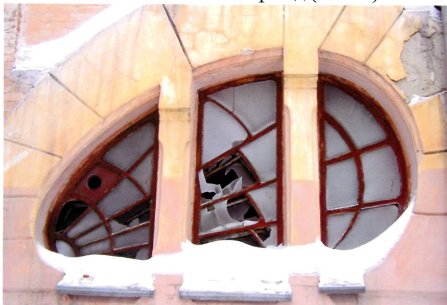
Видовая точка № 18. Окно яйцевидной конфигурации из трех проемов и его первоначальный вид заполнения. Торец западного фасада (2006 г.).
